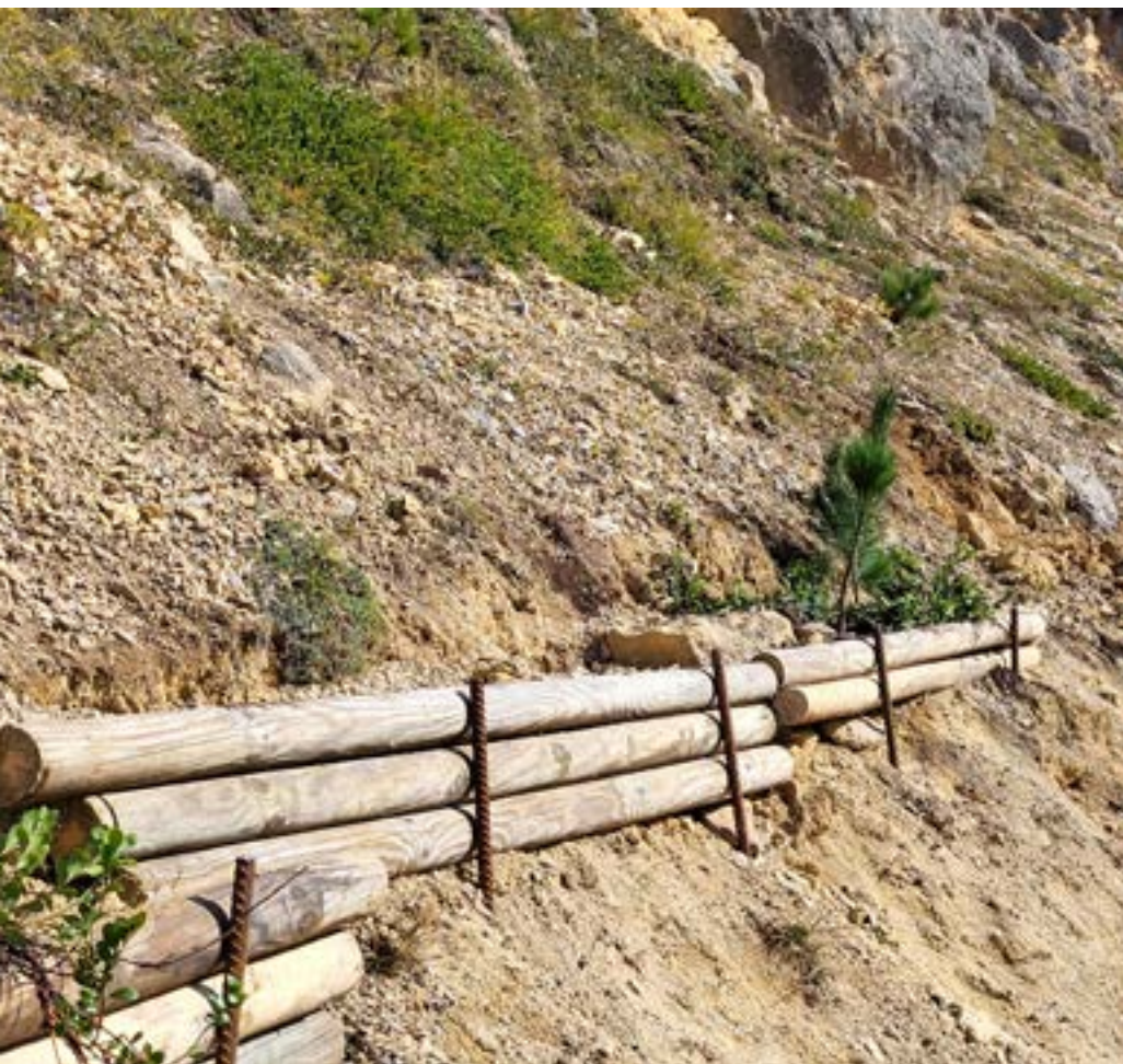
Construction de banquettes et plantations de Pinus cembra et Arctostaphylos uva-ursi 📷 André EVETTE, INRAe
